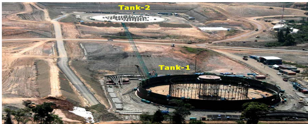
LNG Storage Tanks
